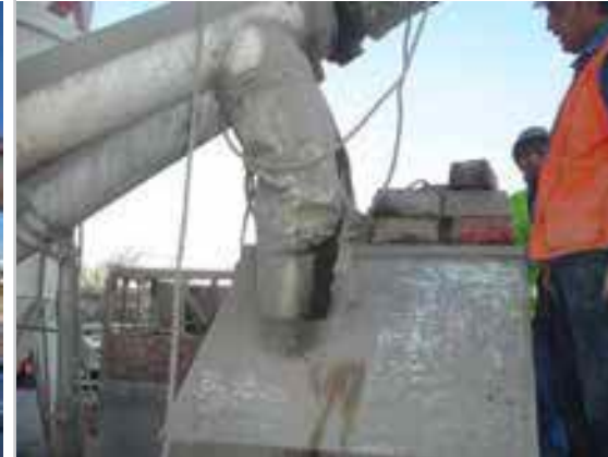
VERIFICACIÓN BÁSCULAS DE CEMENTO Y ADICIONES
